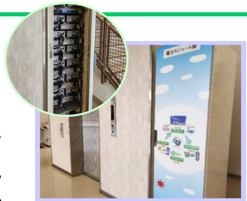
蓄電池充電システム
