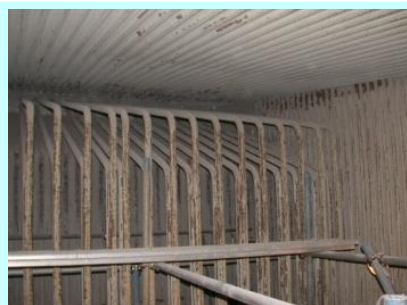
ボイラー (内部)
