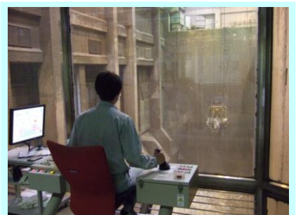
ごみクレーン操作室
