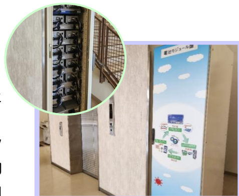
蓄電池充電システム
