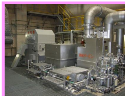
蒸気タービン発電機外観
