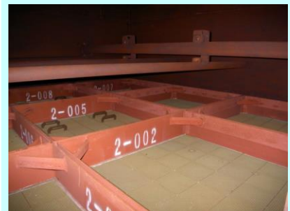
脱硝反応塔（内部）
