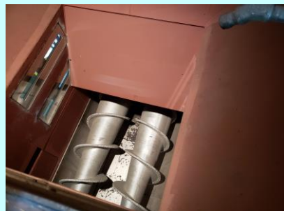
給じん機 (内部)
