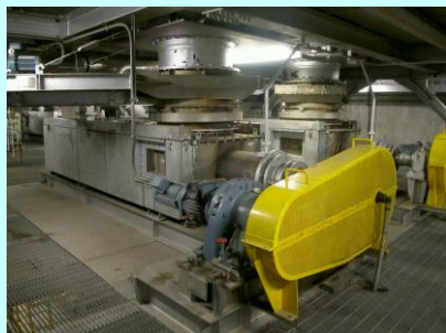
不燃物排出装置外観
