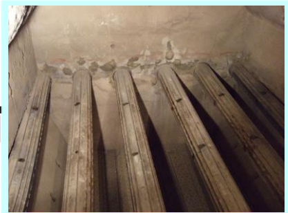
焼却炉内部 (流動砂のない状態)
