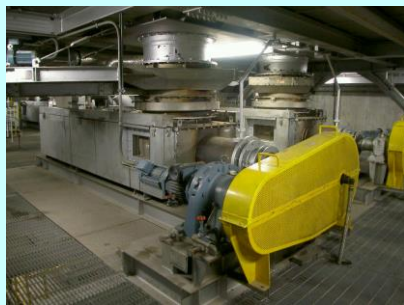
不燃物排出装置外観
