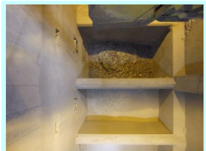
焼却残さピット (金属類・不燃物等)
