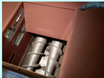
給じん機 (内部)
