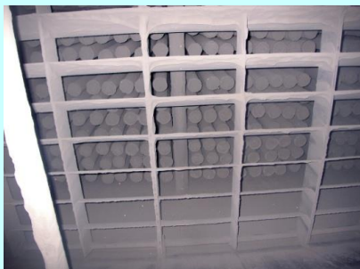
バグフィルター（内部）
