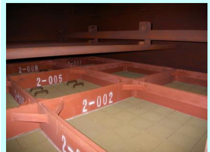
脱硝反応塔（内部）
