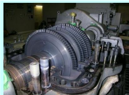
蒸気タービン発電機 (内部)
