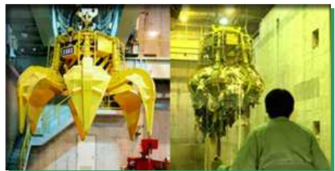
ごみクレーン/ 操作室
