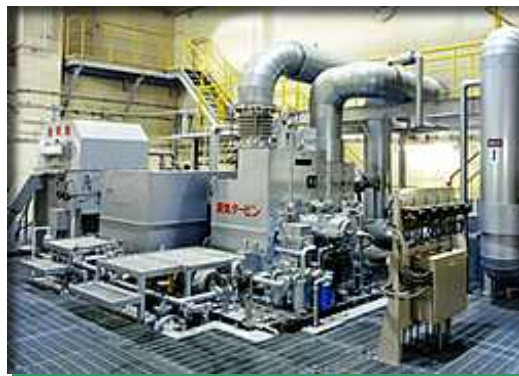
蒸気タービン・発電機
