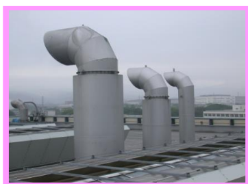
環境センター屋上サイレンサー
