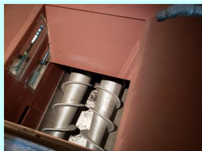
給じん機 (内部)
