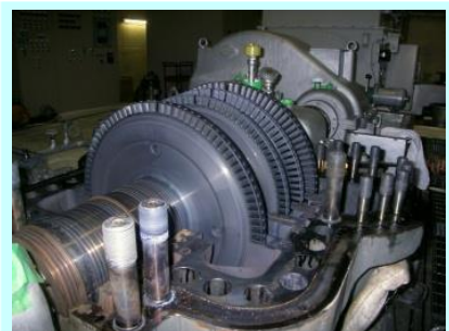
蒸気タービン発電機 (内部)
