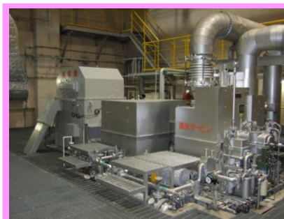
蒸気タービン発電機外観
