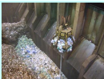
ごみピット/ごみクレーン
