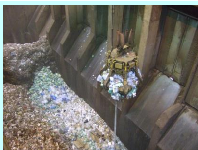
ごみピット/ごみクレーン
