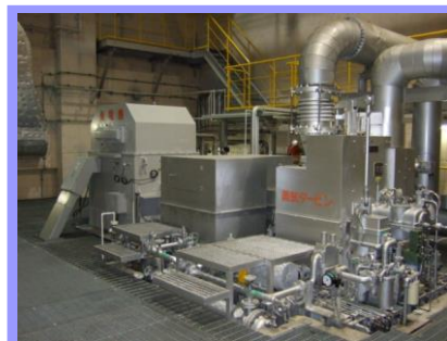
蒸気タービン発電機外観
