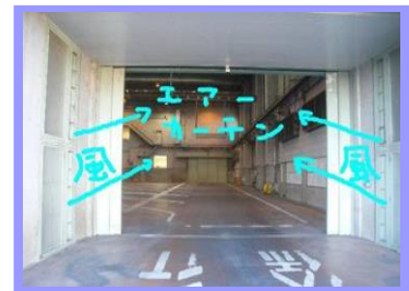
プラットホーム自動ドア（エアカーテン）
