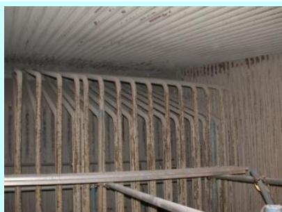
ボイラー (内部)
