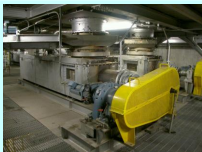
不燃物排出装置外観
