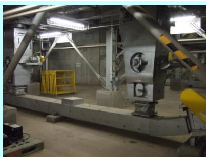
ダスト搬送コンベヤ (バグフィルター下)
